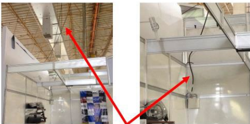
Cabo fornecido pelo EXPO Center Norte.
